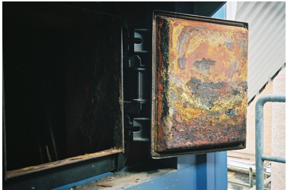
Kuva 1. Ilmavotojen syövyttämä tarkastusluukku.
