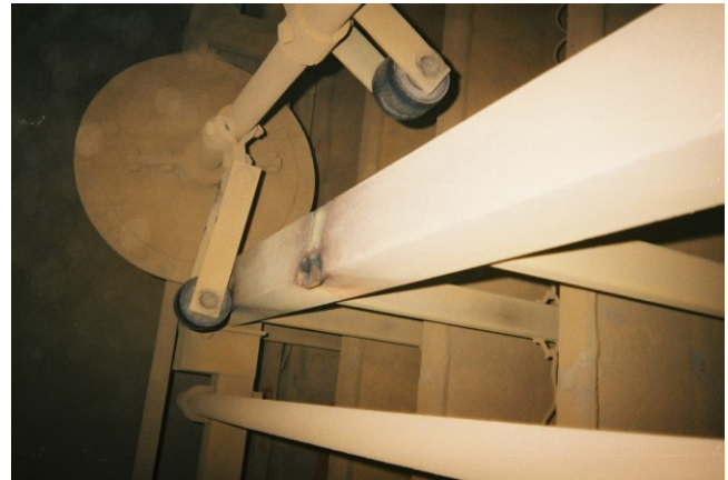
Kuva 8. Tyssääntynyt emissioravistuksen iskupalkki.
