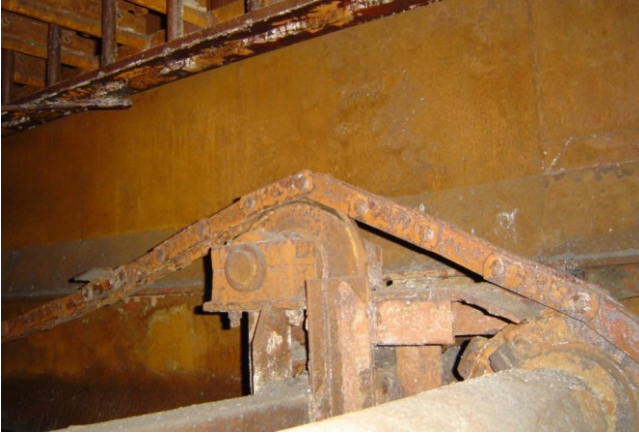
Kuva 10. Korroosion vaurioittama laahakuljetin.
