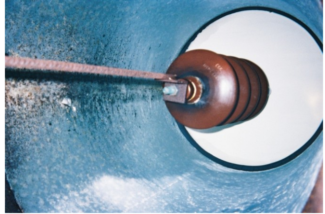
Kuva 11. Kärjestä rikkoontunut muuntajan läpivientieristin.
